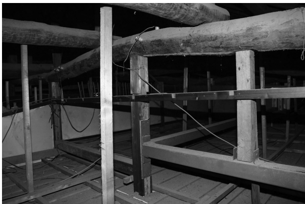
写真⑱ 小屋裏 旧廻縁痕跡
