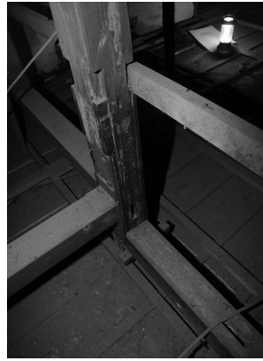
写真⑰ 小屋裏 壁痕跡
