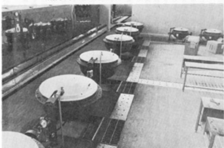
▲ 蒸気回転ガマ 6 台 ガスガマ 2 台
