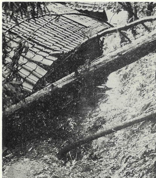
南坂、山田弘さん方裏山の土砂崩れ
