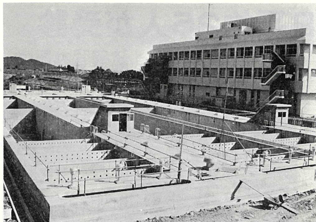
給水能力(1日)40,325ト 県浄水場(山之上町中之番)
