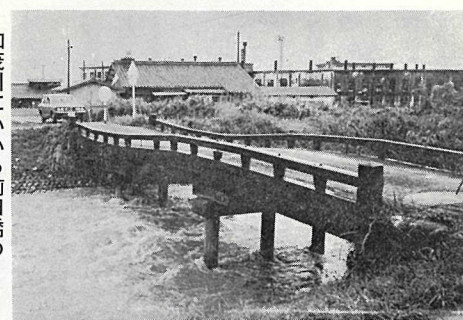
加茂川にかかる前田橋の橋げたが流失
