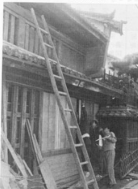
被害調査が進められる旧脇本陣林家住宅
