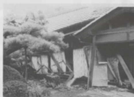
＜裏山が崩れ全壊した民家…蜂屋＞
