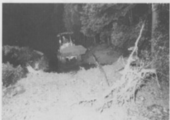
土砂で埋まった道路を徹夜で復旧…伊深
